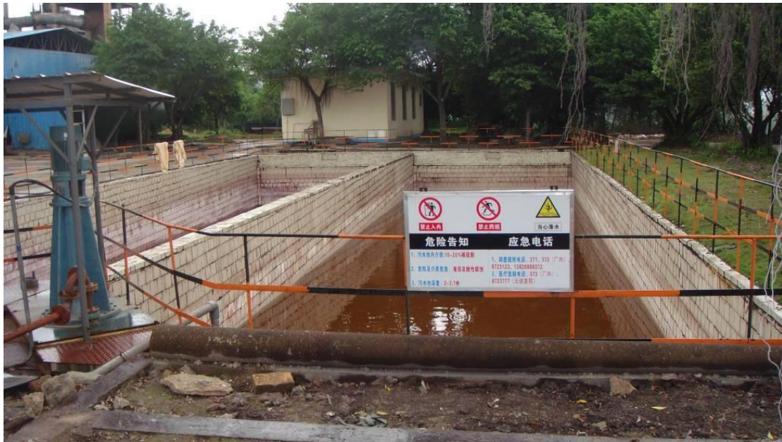
图 3.2-18 污水站调节池及危险警示牌
