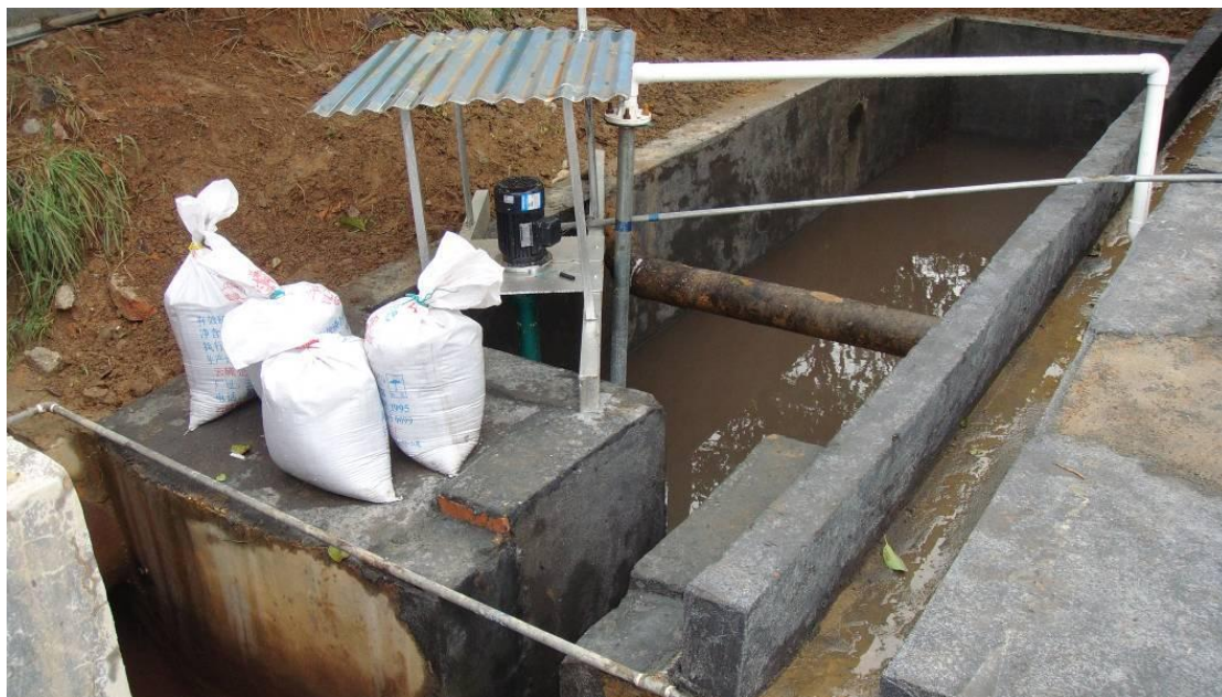
图 3.2-20 初期雨水缓冲池
